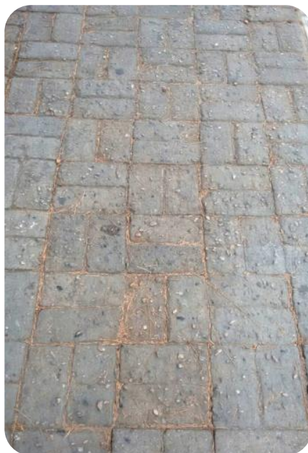
Figura 3. Pavimento com severo desgaste superficial por abrasão
