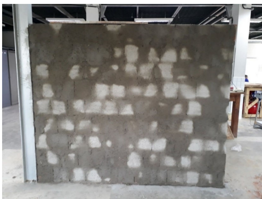
Figura 21 - Parede chapiscada sem solução de cal
