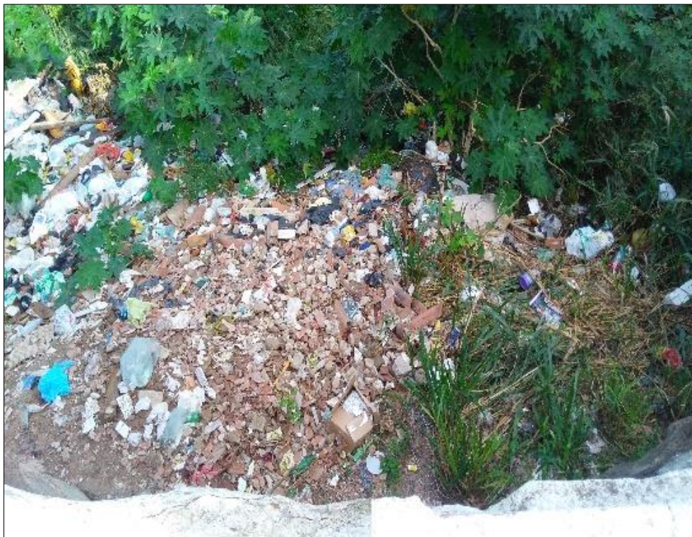
Figura 4. Deposição de lixo e entulho sobre a encosta
