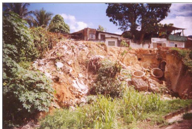
Figura 8. Erosão devido a vazamento de tubulações de águas servidas
