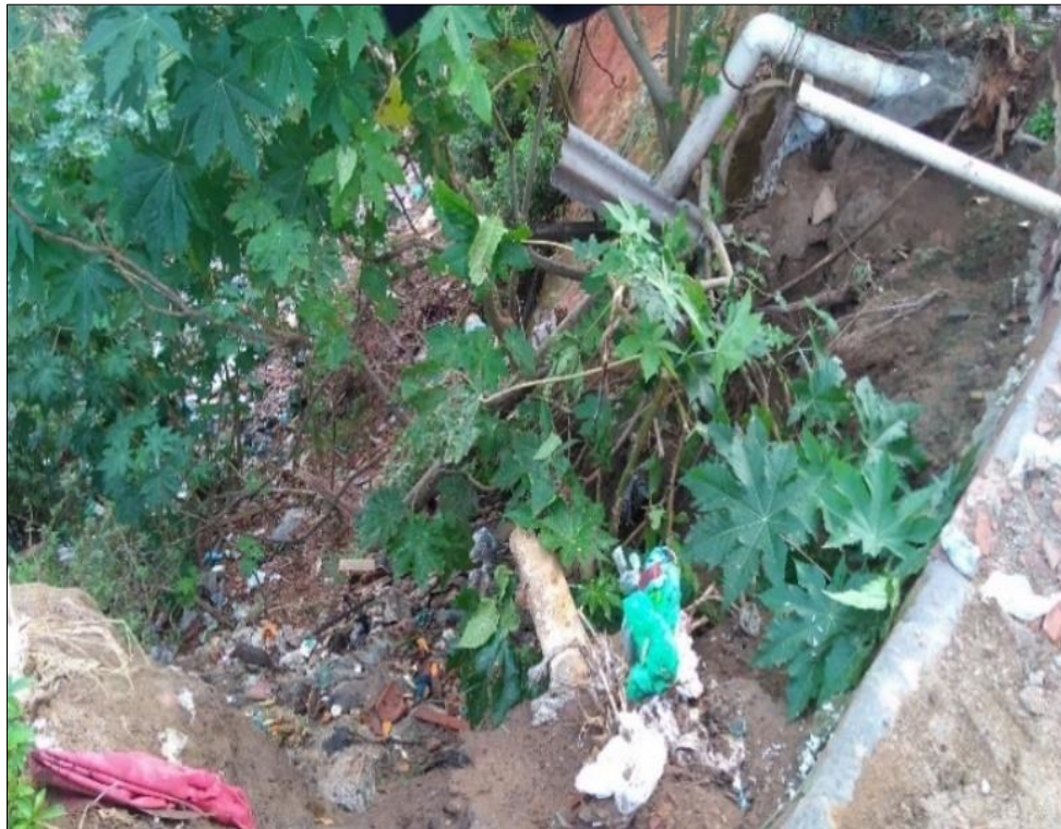
Figura 3. Despejo de águas servidas diretamente na encosta
