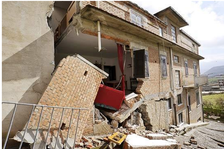
Figura 4 – Casa destruída após deslizamento de terra em San Fratello (ITA)
