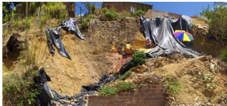
Figura 19 – Local do Deslizamento no bairro do Ibura (Recife-PE)
