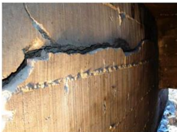
Figura 1.5 - Deslocamento horizontal relativo em bloco de fundação, Gomes (2008)
