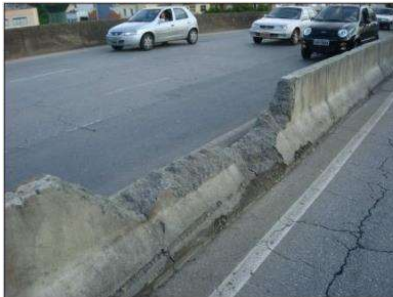
Figura 9: Deterioração do concreto por ações mecânicas.
