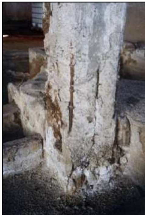
Figura 13: Pilar degradado pela ação íons sulfato.
