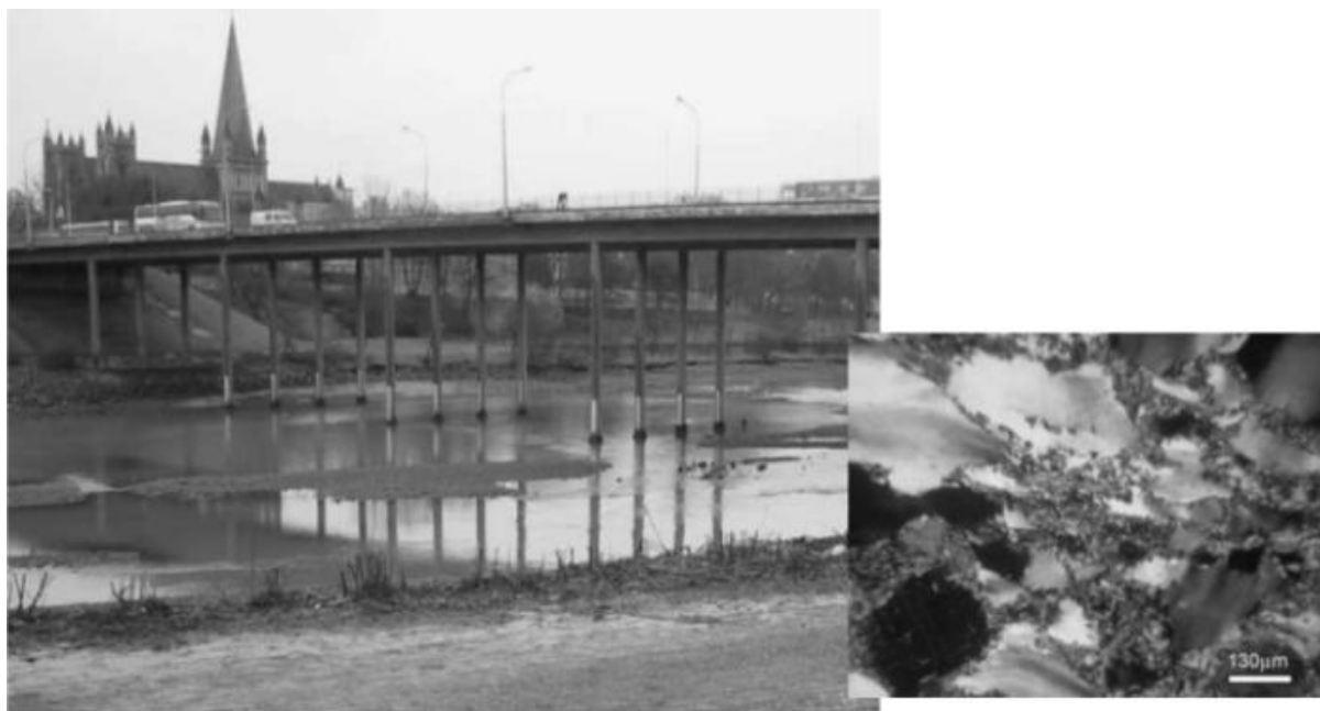
Figura 8 - Ponte Elgester na Noruega, afetada pela RAA
