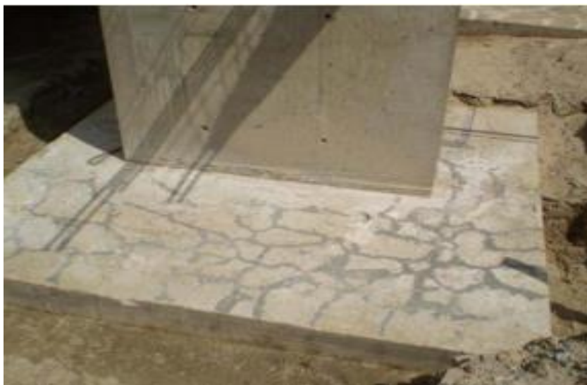
Figura 33 - Fissuração do tipo mapa em bloco de fundação de edifício em construção
