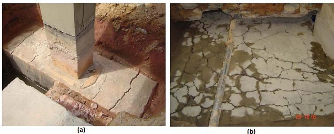
Figura 11 - a) Fissuras em bloco sobre duas estacas. b) Fissuras em bloco com 18 estacas.
