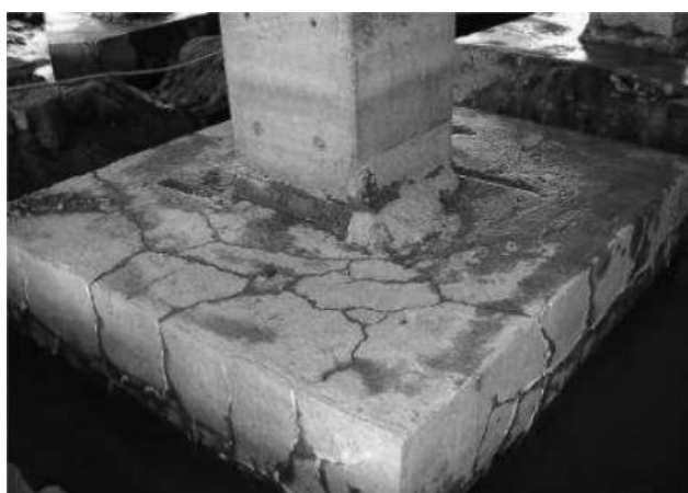
Figura 3 - Bloco de fundação com padrão de fissuração típico de RAA
