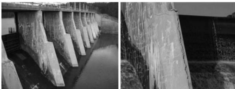
Figura 2 - Paredes dos vertedouros em barragem nos Estados Unidos, detectado a ocorrência da RAA
