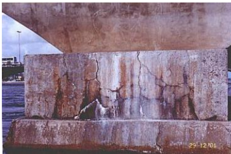
Figura 6 - Fissuração em bloco de apoio do vão central da ponte Paulo Guerra
