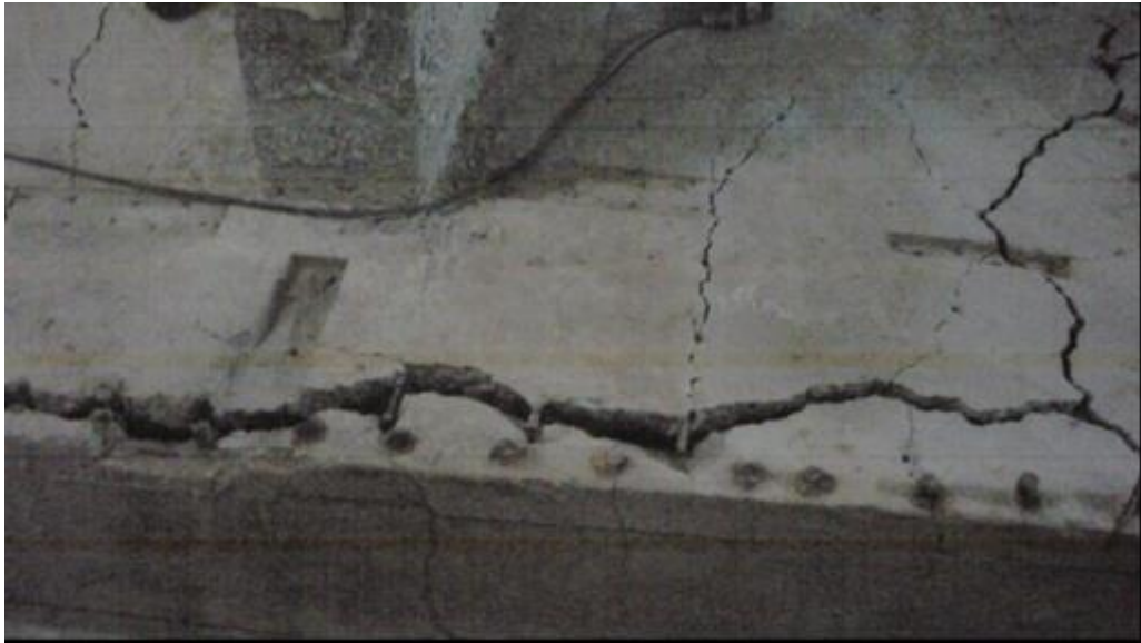
Figura 35c - Exemplo de degradação da classe crítica
