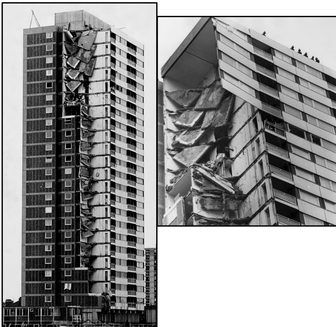
Figura 5 - Edifício do Ronan Point.
