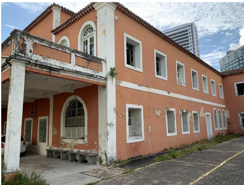
Fotografia17 - Fachada Leste - vegetação e umidade
