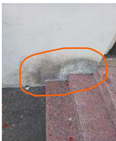
Fotografia 2 – Eflorescência na alvenaria
