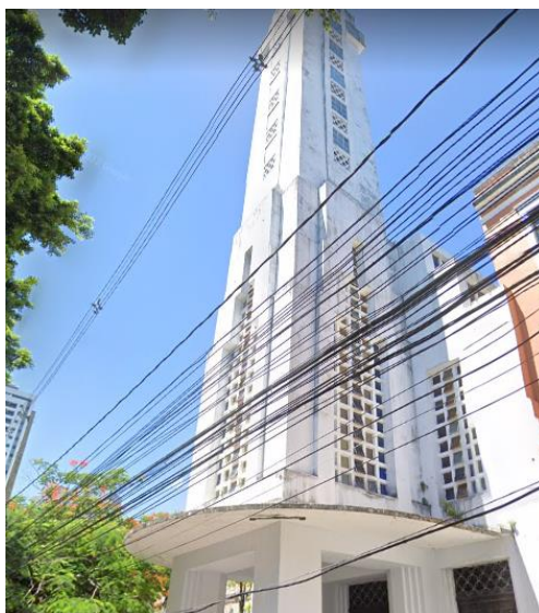
Fotografia 11 - Fachada frontal - sujidades
