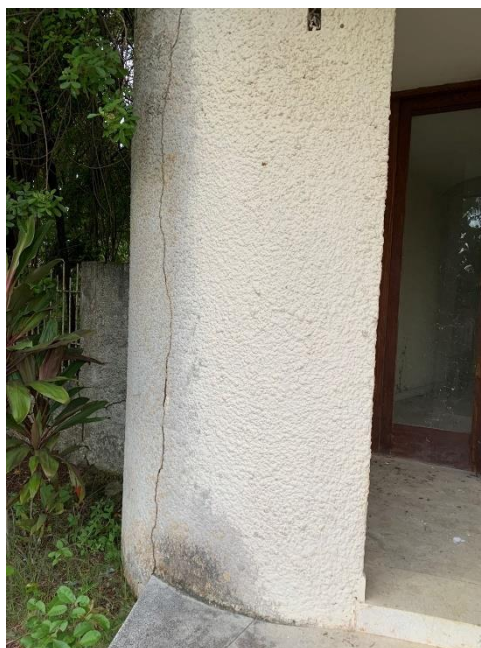
Fotografia 27 – Fissura na fachada frontal
