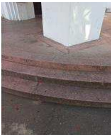
Fotografia 8 – Fachada frontal - Fissuras
