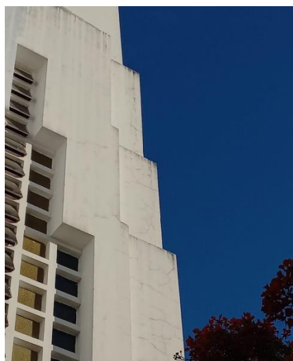
Fotografia 13 - Fachada frontal - sujidades
