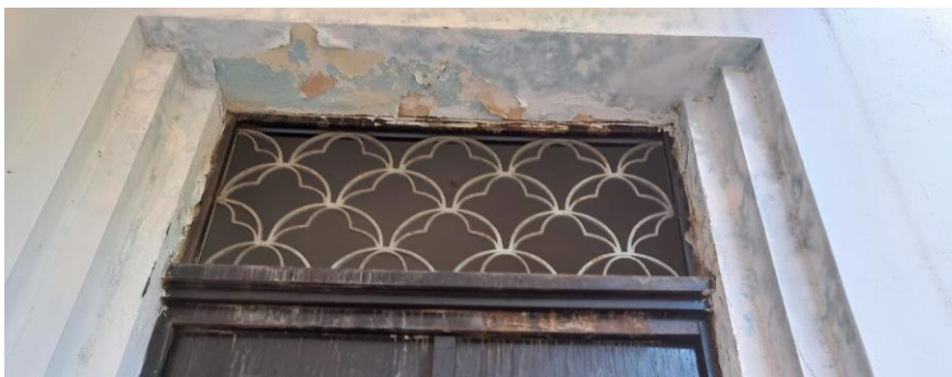
Fotografia 5 – Descascamento da pintura na edificação
