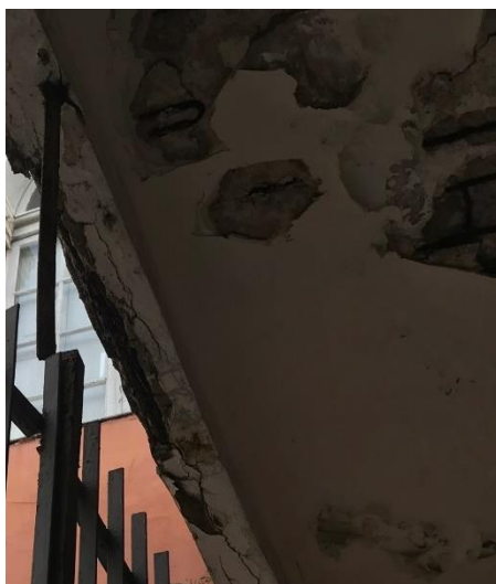
Fotografia 21 - Fachada Noroeste - fissuras.
