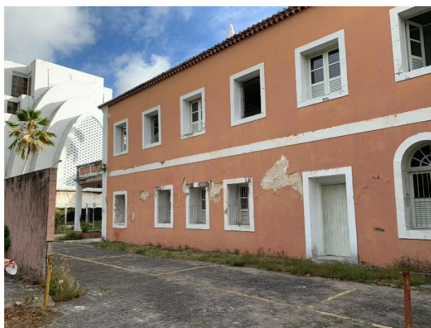
Fotografia 18 – destacamento da pintura
