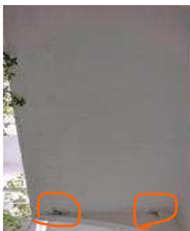
Fotografia 7 - Fachada frontal – musgo e bolor
