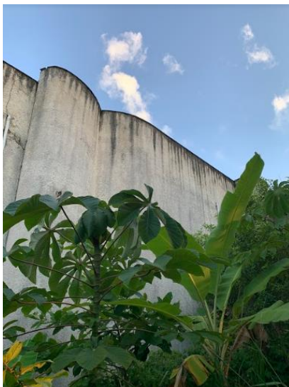
Fotografia 23 – Fachada leste da igreja de são José – sujeidade e crosta negra.
