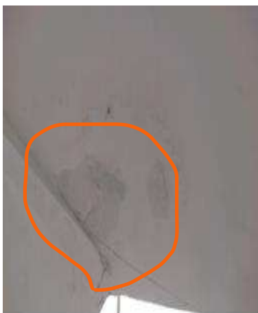
Fotografia 4 – Manchas de humidade na edificação 2
