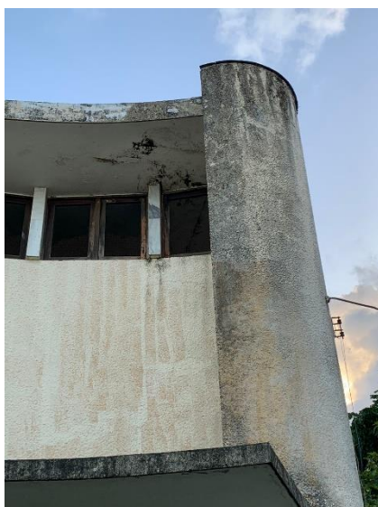
Fotografia 25 – Fachada Frontal da igreja de são josé – sujidade, crosta negra e eflorescência.
