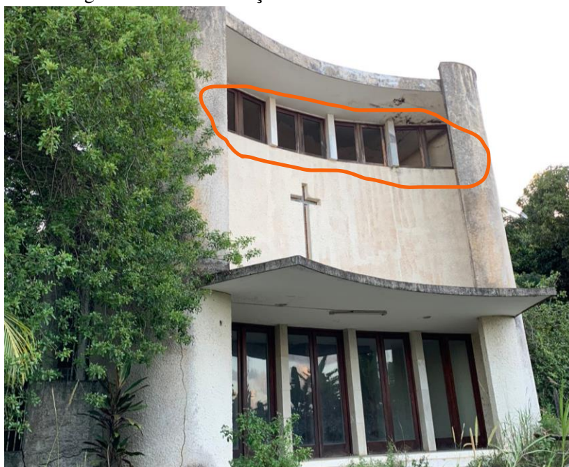
Fotografia 26 – Deterioração da madeira – fachada frontal
