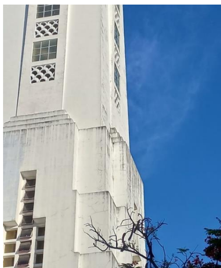
Fotografia 12 - Fachada frontal - sujidades
