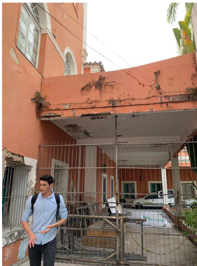
Fotografia 20 - Fachada Leste – corrosão das grades e aço aparente em corrosão.
