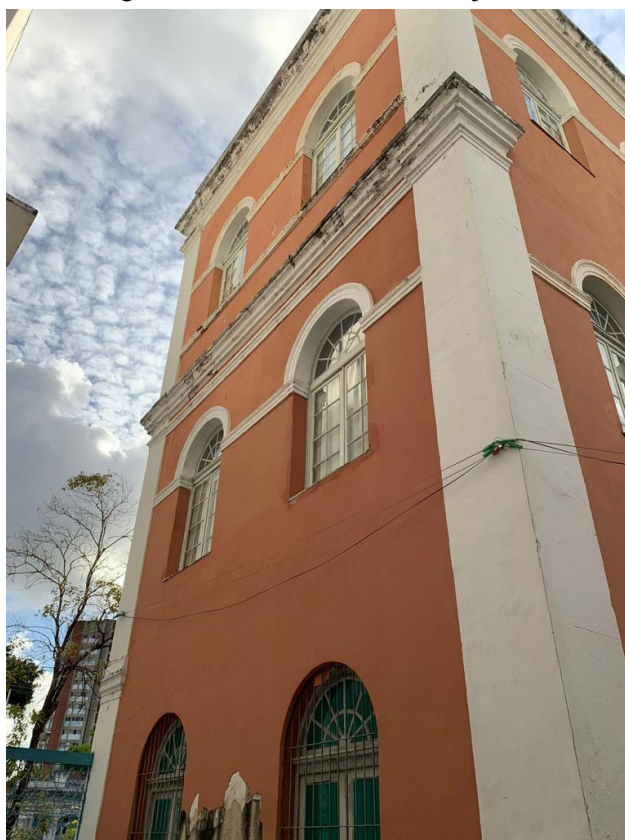
Fotografia 15 - Fachada Leste - Sujidades
