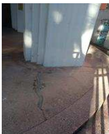
Figura 10 - Fachada frontal - Fissuras
