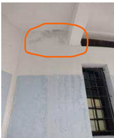
Fotografia 3 – Manchas de humidade na edificação
