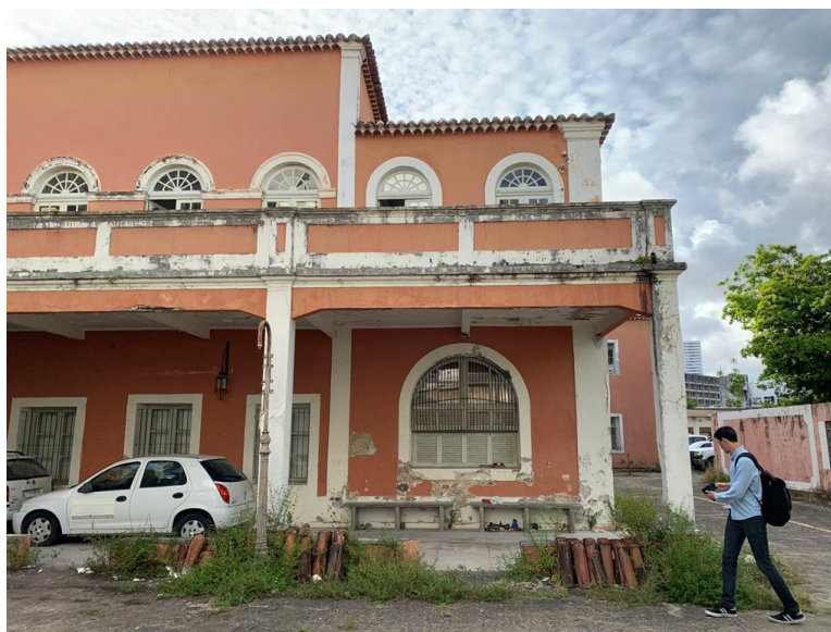
Fotografia 16 - Fachada Leste - Sujidades e vegetação
