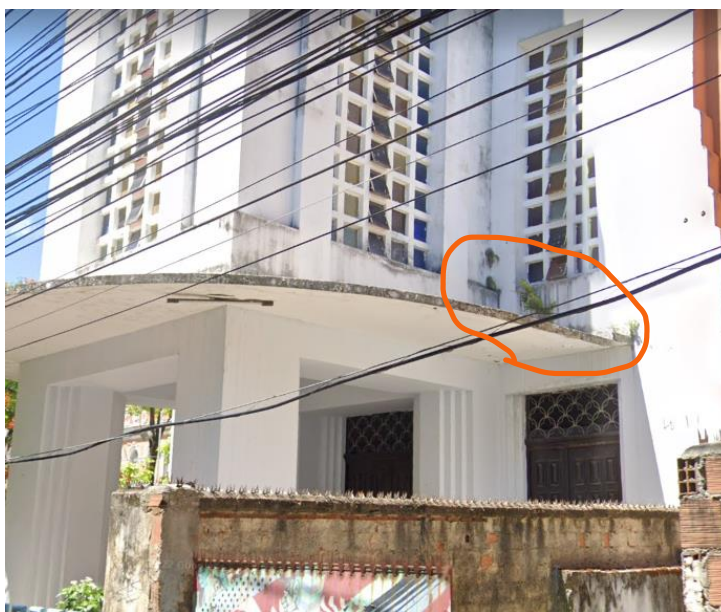
Fotografia 6 - Fachada frontal – Vegetação na construção
