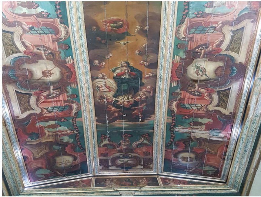
Figura 12 – Pintura no Forro da Nave
