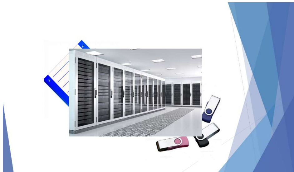
Imagem 8 - Servidor – Data Center do TJPE
