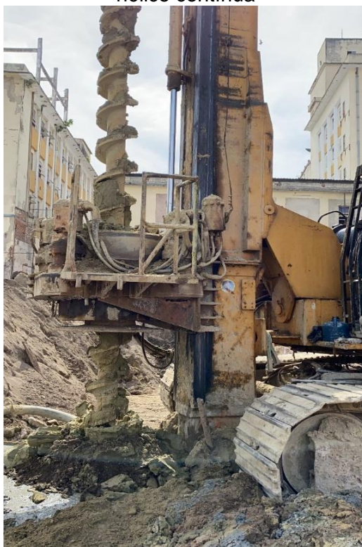
Figura 9 – Imagem do maquinário executando a escavação para a estaca do tipo hélice contínua
