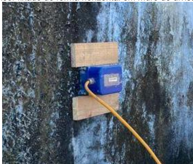
Figura 37 – Sensor fixado de forma horizontal em muro de divisão entre terrenos
