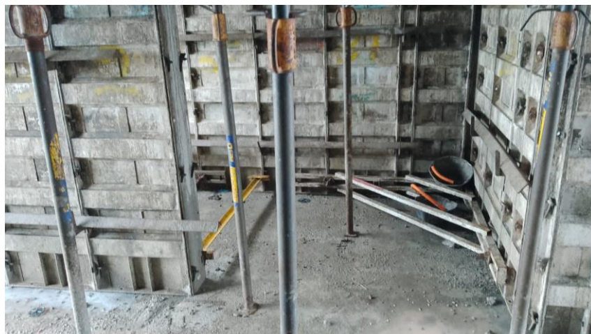
Figura 23 - Sistema de escoramento metálico
