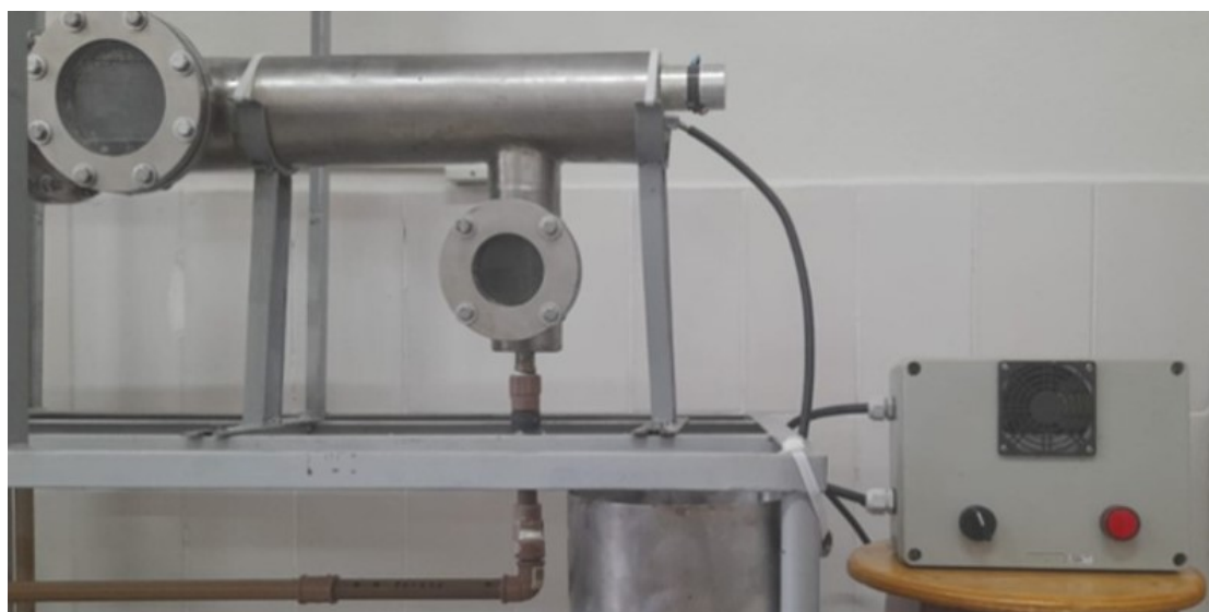
Figura 9 - Fotografia do detalhe de instalação do transdutor ultrassônico no decantador contínuo com camada líquida coalescente
