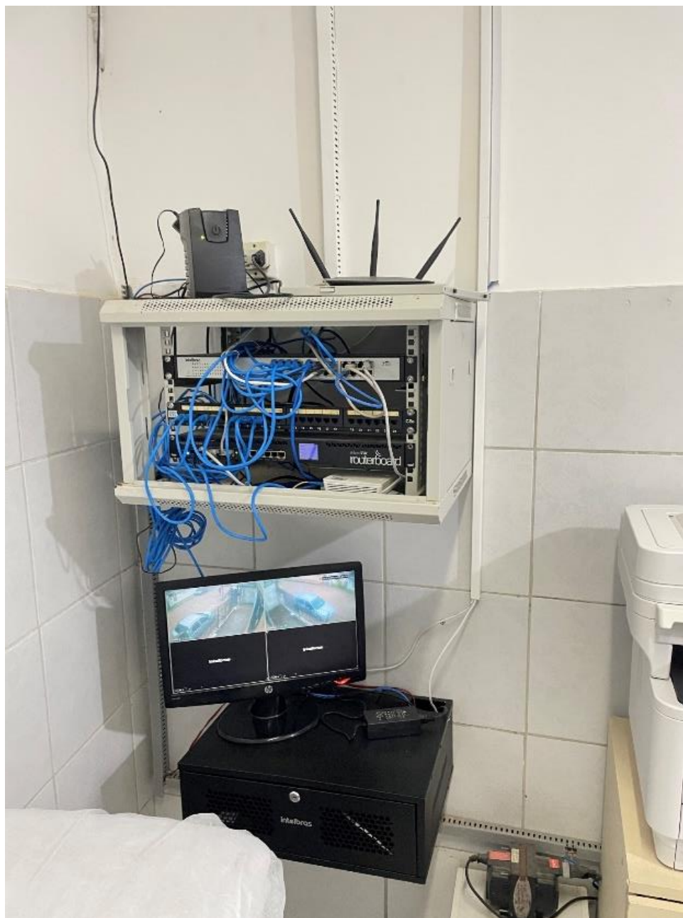
Quadro 30- Ligação irregular Consultório 1
