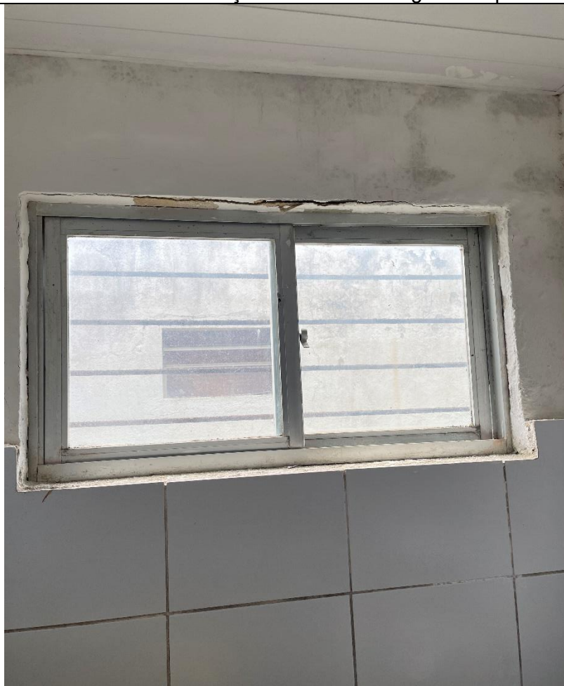
Quadro 43 - Infiltração e fissura de verga na Copa
