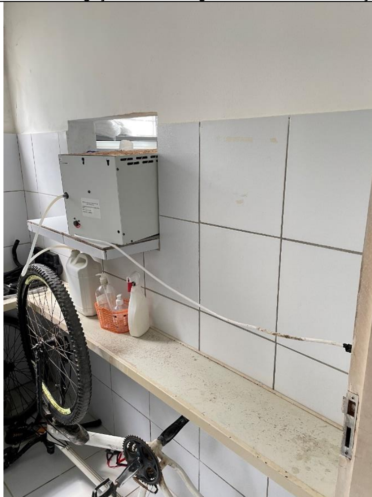
Quadro 42 -Ligação elétrica irregular na sala de esterilização
