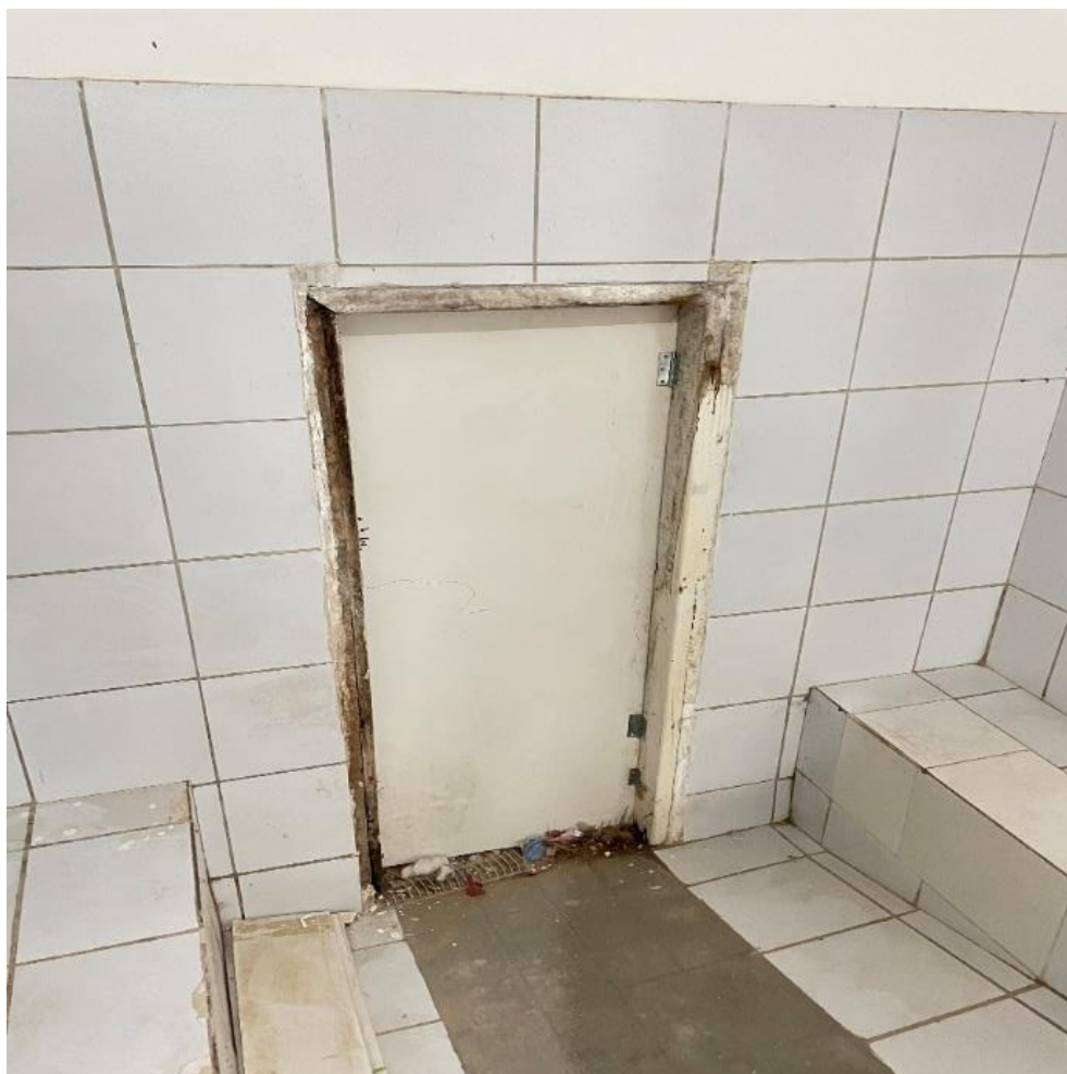
Quadro 26 - Antiga farmácia com a presença de fungos em seu interior
