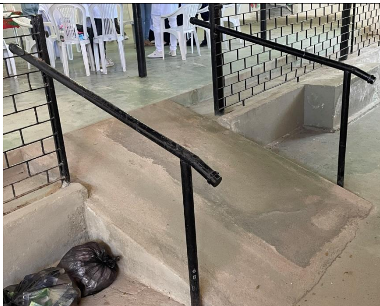
Quadro 76- corrimão de apoio
