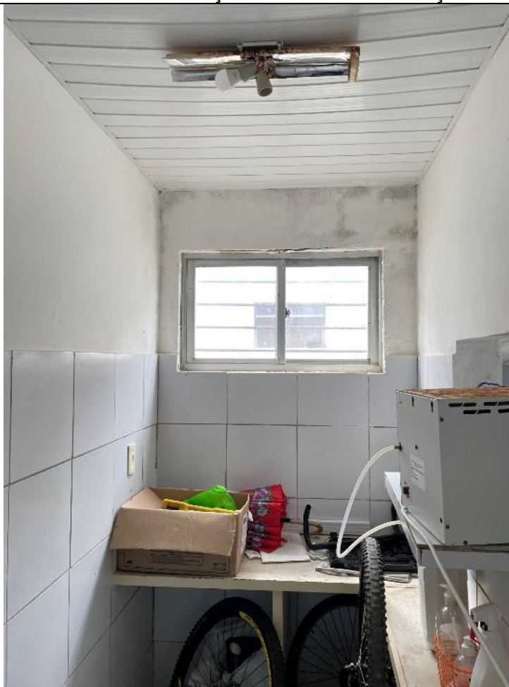
Quadro 41-Infiltração na sala de esterilização
