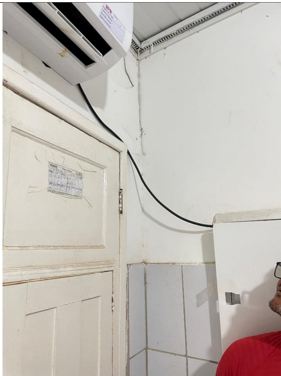
Quadro 27- Ligação irregular do ar-condicionado sala consultório 1
