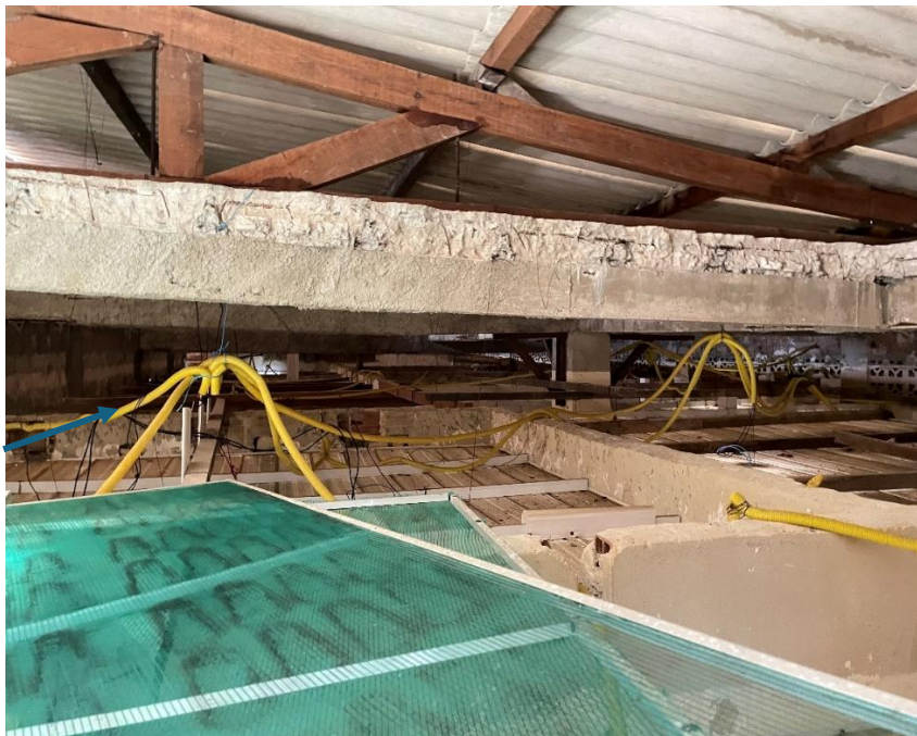
Quadro 45 - Ferragem exposta da cobertura
