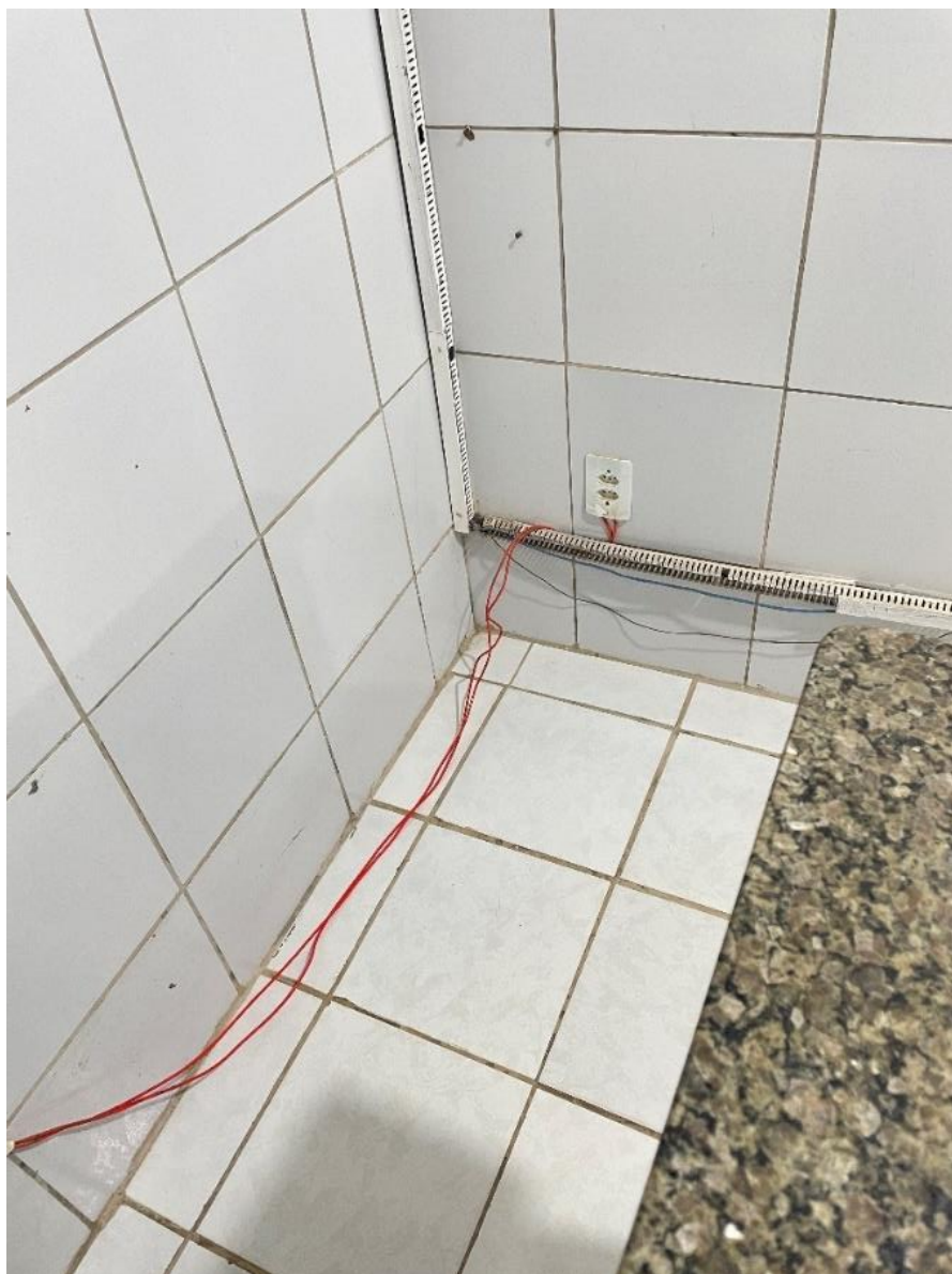
Quadro 29 – ligação irregular Consultório 1
