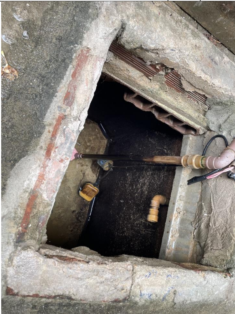
Quadro 47 - Reservatório inferior (cisterna)
