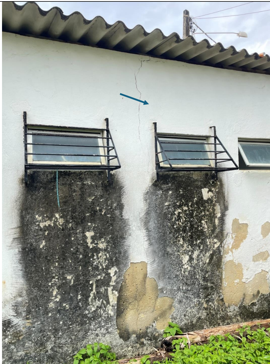
Quadro 46 - Bolor e descolamento do revestimento de tinta da fachada
