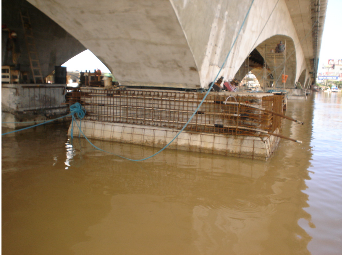
Figura 3.14 – Ferragem frouxa e cabos de protensão dos blocos
