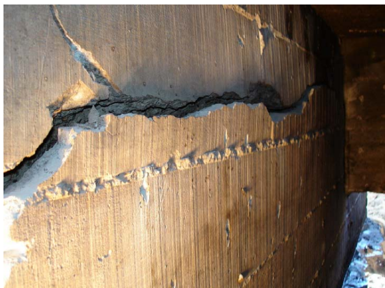
Figura 3.25 – Trinca horizontal com grande abertura e deslocamento relativo entre as superfícies delimitadas pela trinca Fonte: : ANDRADE, 2007
