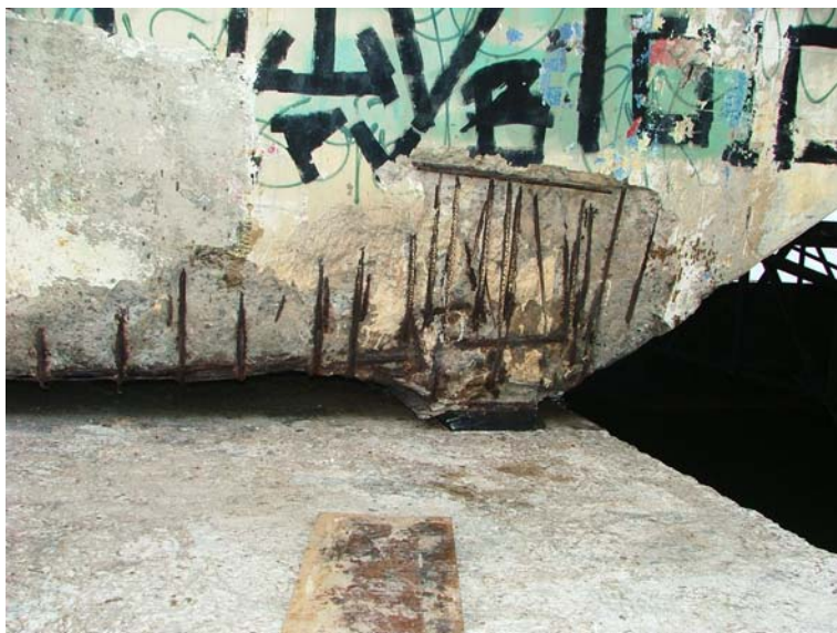
Figura 3.3 – Deterioração do concreto nos apoios extremos.
