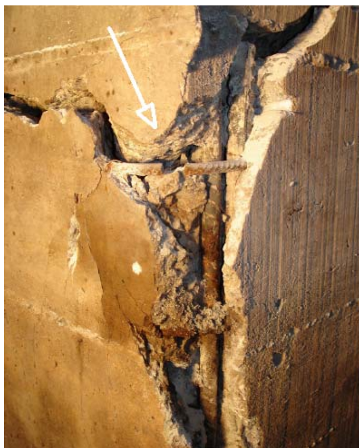
Figura 3.26 – Estribo rompido no encontro de duas faces laterais de um bloco. Fonte: ANDRADE , 2007.
