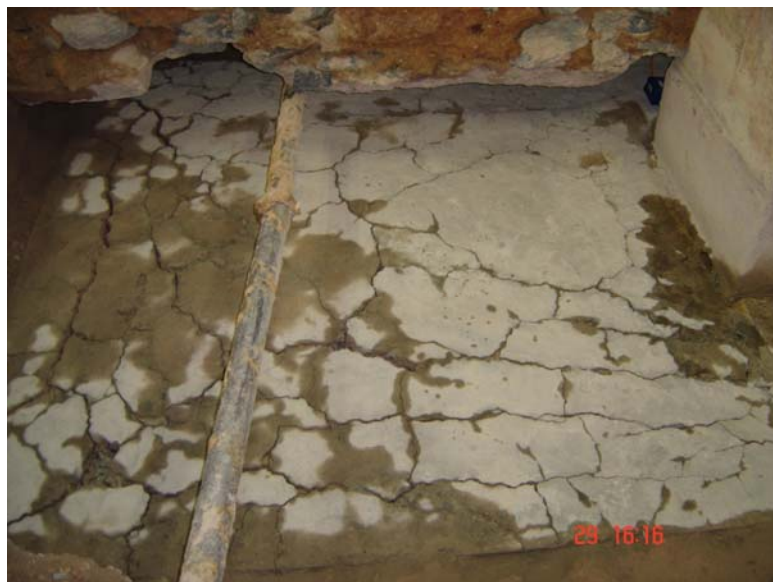
Figura 3.18 – Fissuras em um bloco com 18 estacas, com dimensões 8 x 6 m Fonte: Acervo dos proprietários do edifício
