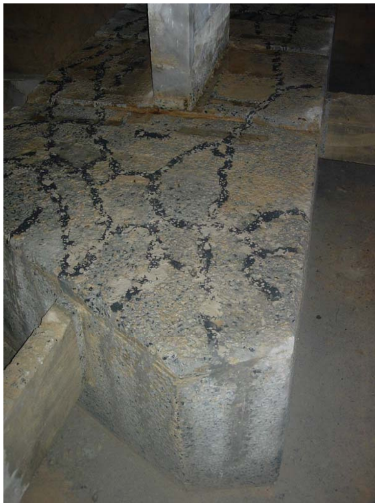
Figura 3.41 – Aspecto de um bloco de fundação mostrando fissuras já preenchidas
