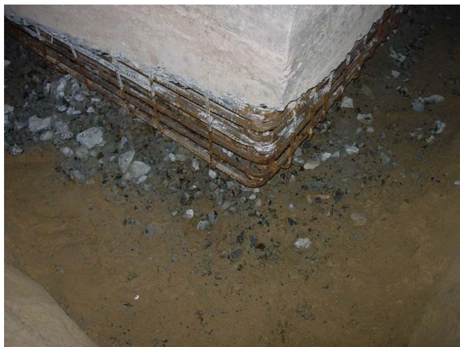
Figura 3.43 – O mesmo bloco da Figura 3.42 com a ferragem do reforço anterior sem o devido envolvimento com concreto. Fonte: o autor
