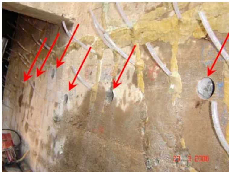
Figura 3.30 – Furos (testemunhos) abaixo da trinca principal para retirada de solo do fundo da trinca.
