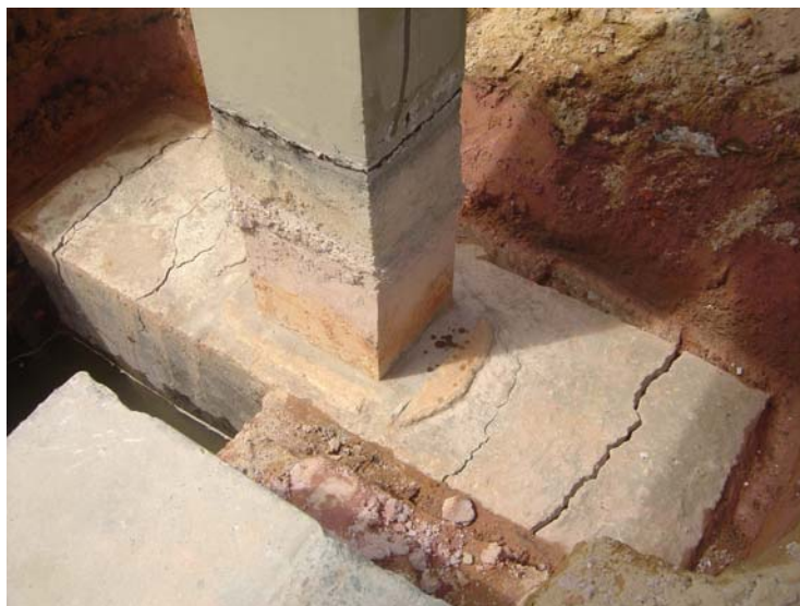
Figura 3.17 – Fissuras em um bloco sobre duas estacas, com dimensões 1 x 2,5 m Fonte: Acervo dos proprietários do edifício.
