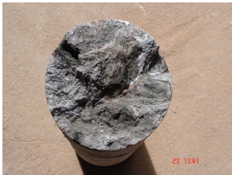
Figura 3.19 – Testemunho mostrando bordas de reação. Fonte: Acervo da Construtora BETONPOXI
