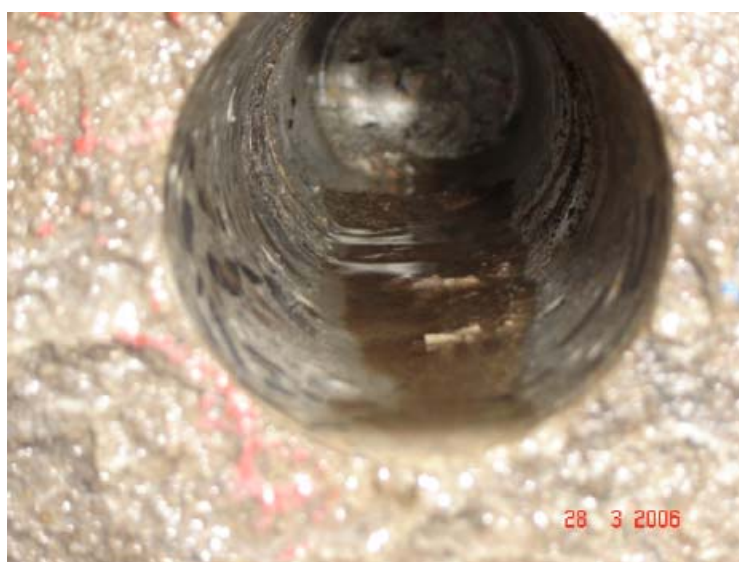
Figura 3.31 – Furo de 3” abaixo da trinca principal, durante a lavagem da trinca, mostrando a saída da areia. Fonte: SILVA e OLIVEIRA , (2006)
