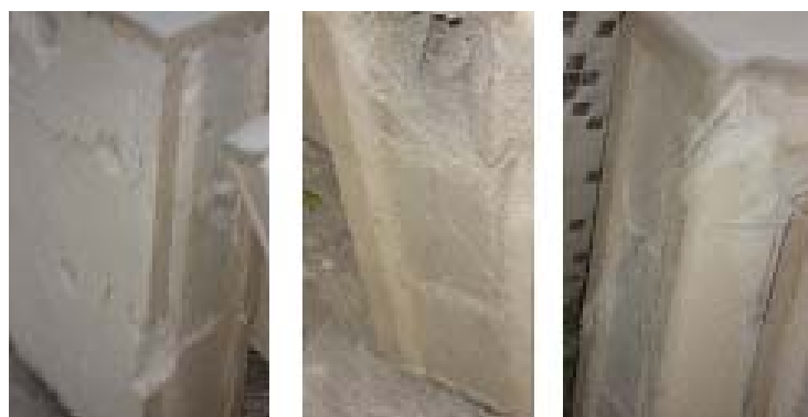
Figura 2.13 - Ruptura dos prismas com reforço de argamassa armada
