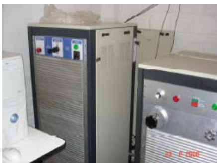
Figura 3.38 - Gabinete de acionamento dos macacos
