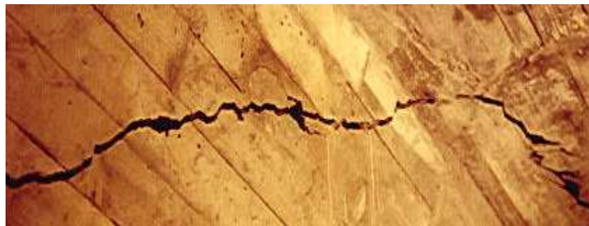
Figura 2. 2 - Fissuras internas na Barragem de Hiwassee- Estados Unidos (ANDRIOLO, 1997).
