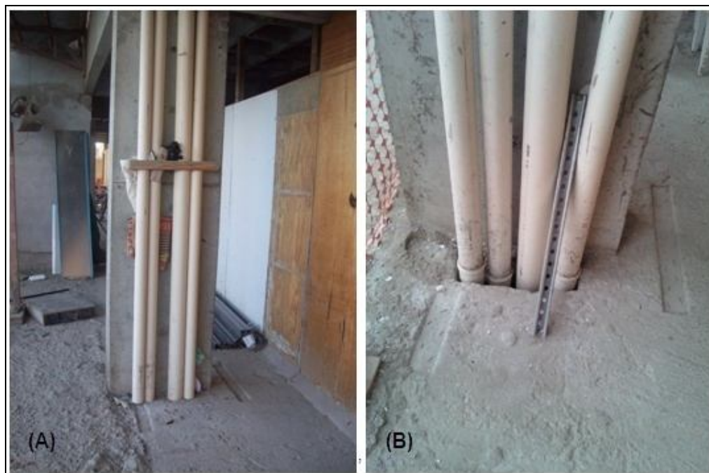
Figura 3.3.14 - Falha no posicionamento dos tubos de queda (A=Antes, B=Depois)
