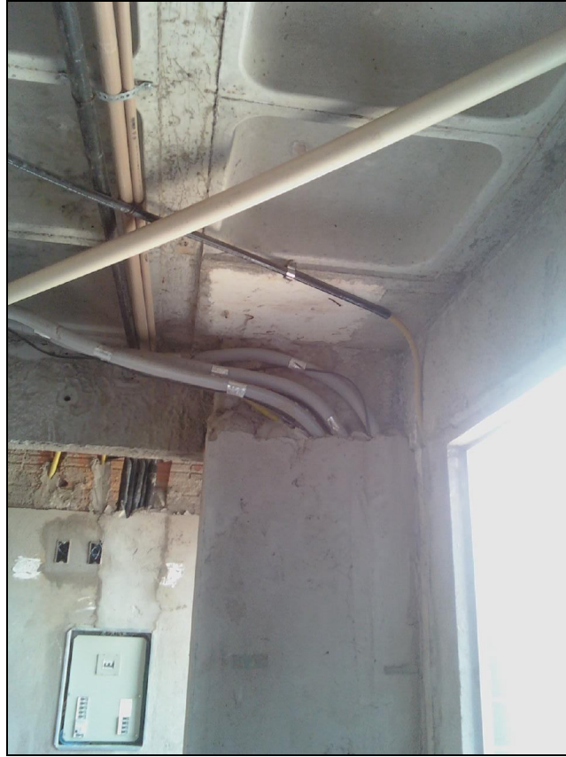
Figura 3.3.18 - Tubos dos arcondicionados split descendo junto ao pilar
