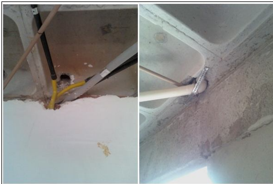
Figura 3.3.17 - Conflito entre a estrutura de concreto e as instalações hidrossanitárias
