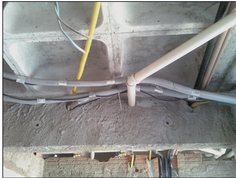
Figura 3.3.19 - Conflito geométrico entre as diversas instalações
