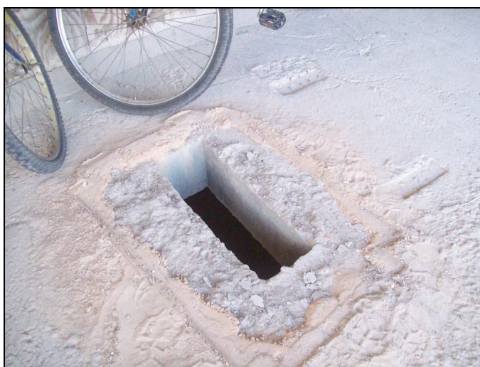
Figura 3.3.15 - Furo na laje destinado ao Shaft
