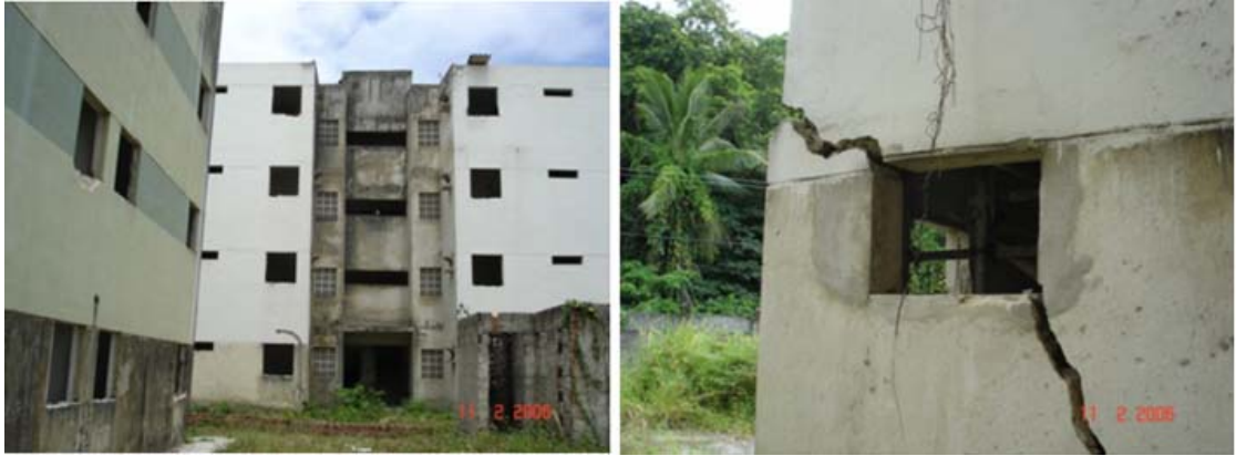
FIGURA 1 - DESAPRUMO DO BLOCO E RACHADURA NO BLOCO EM EDIFÍCIO DA RMR
