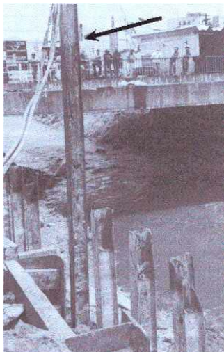
FIGURA 23 – CORROSÃO EM ESTACA METÁLICA DA PONTE DA RUA WANDENKOL SOBRE RIO TAMANDUATEÍ, SÃO PAULO - SP (PERFIS ESTRUTURAIS DA AÇO MINAS)
